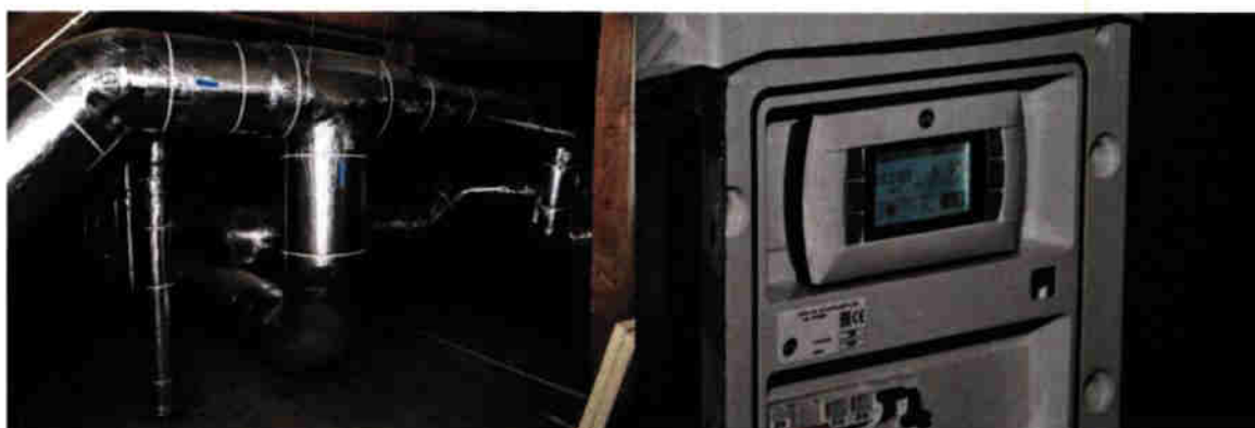
Zdjęcie. 2. Wygląd części instalacji i panelu centrali sterującej.
