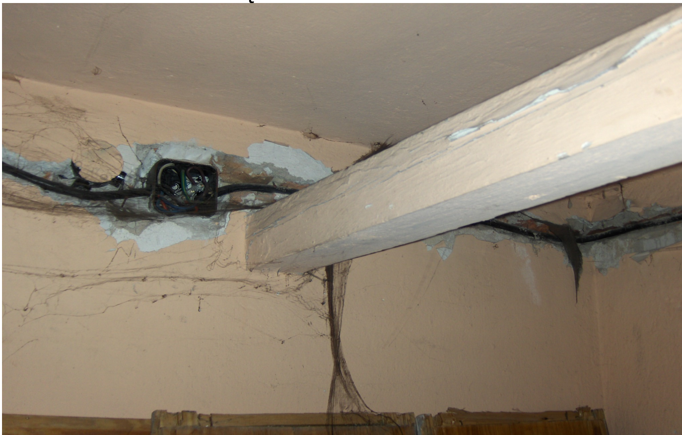
WIDOK PUSZKI PRZYŁĄCZENIOWEJ POM. 1.4.
