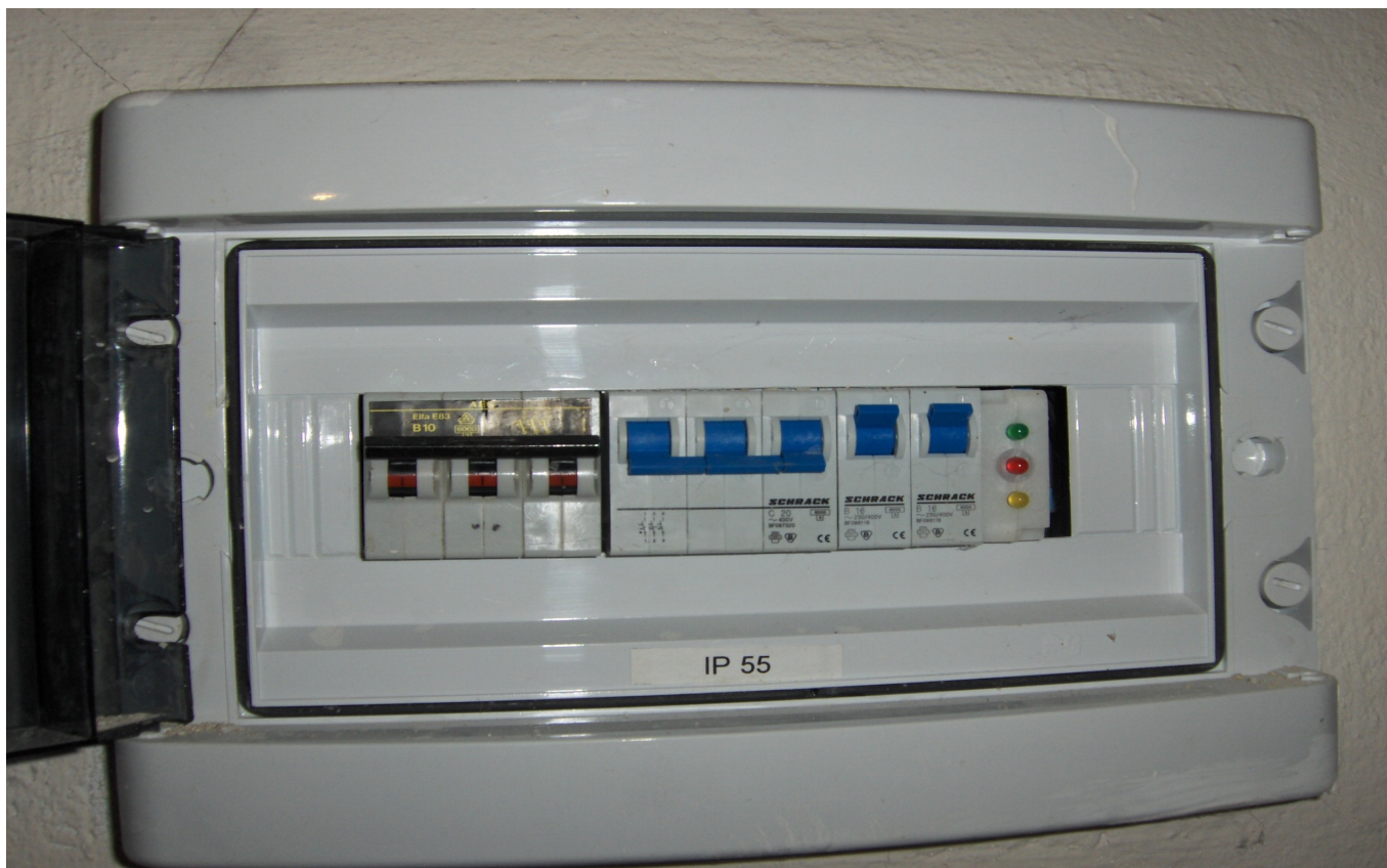
WIDOK ROZDZIELNI POM. 1.1.
