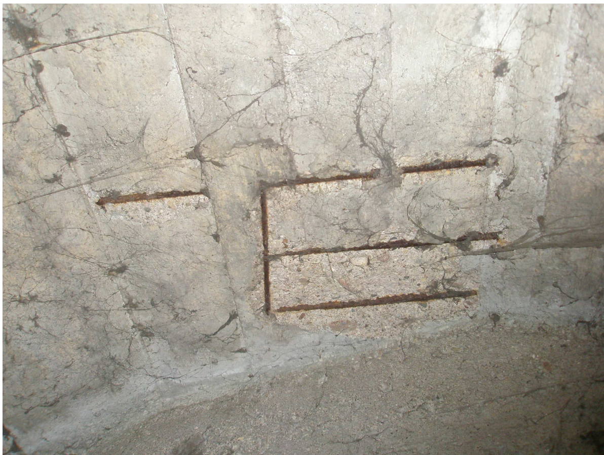
FOT. 5 – Ubytki betonu i skorodowane zbrojenie w płycie pomostu, zabrudzenia
