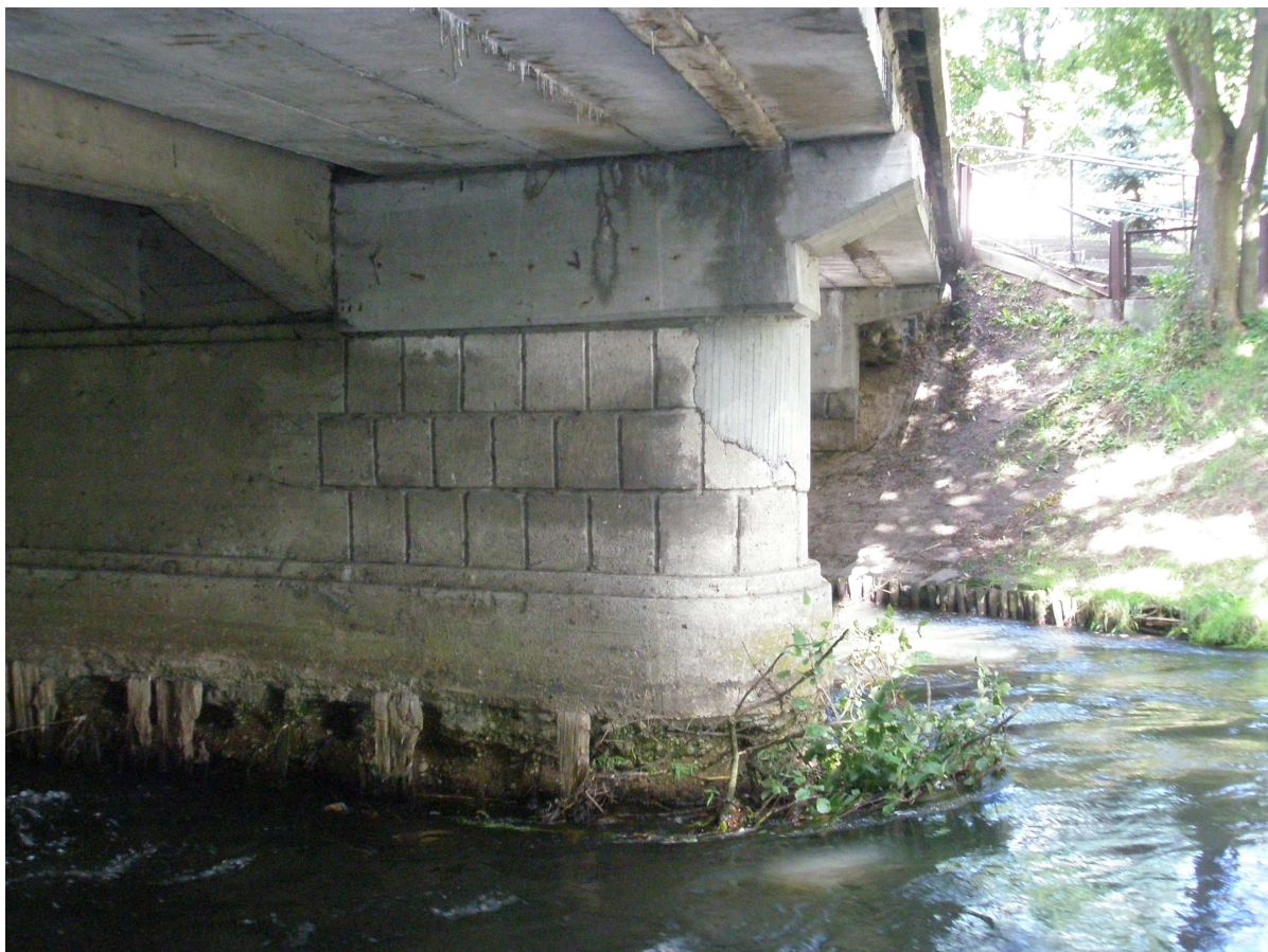
FOT. 4 – Ubytki betonu w podstawie filara, zacieki i nacieki w przęśle poszerzenia mostu
