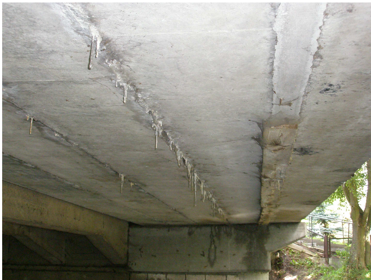
FOT. 2 – nacieki powstałe przez przesączającą się przez elementy konstrukcyjne mostu wodę w wyniku nieszczelnej izolacji.
