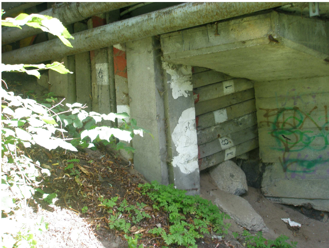
FOT. 1 – brak skrzydełek ( prowizoryczne zabezpieczenie pachołkami ) powoduje wymywanie ziemi i osiadanie nasypu
