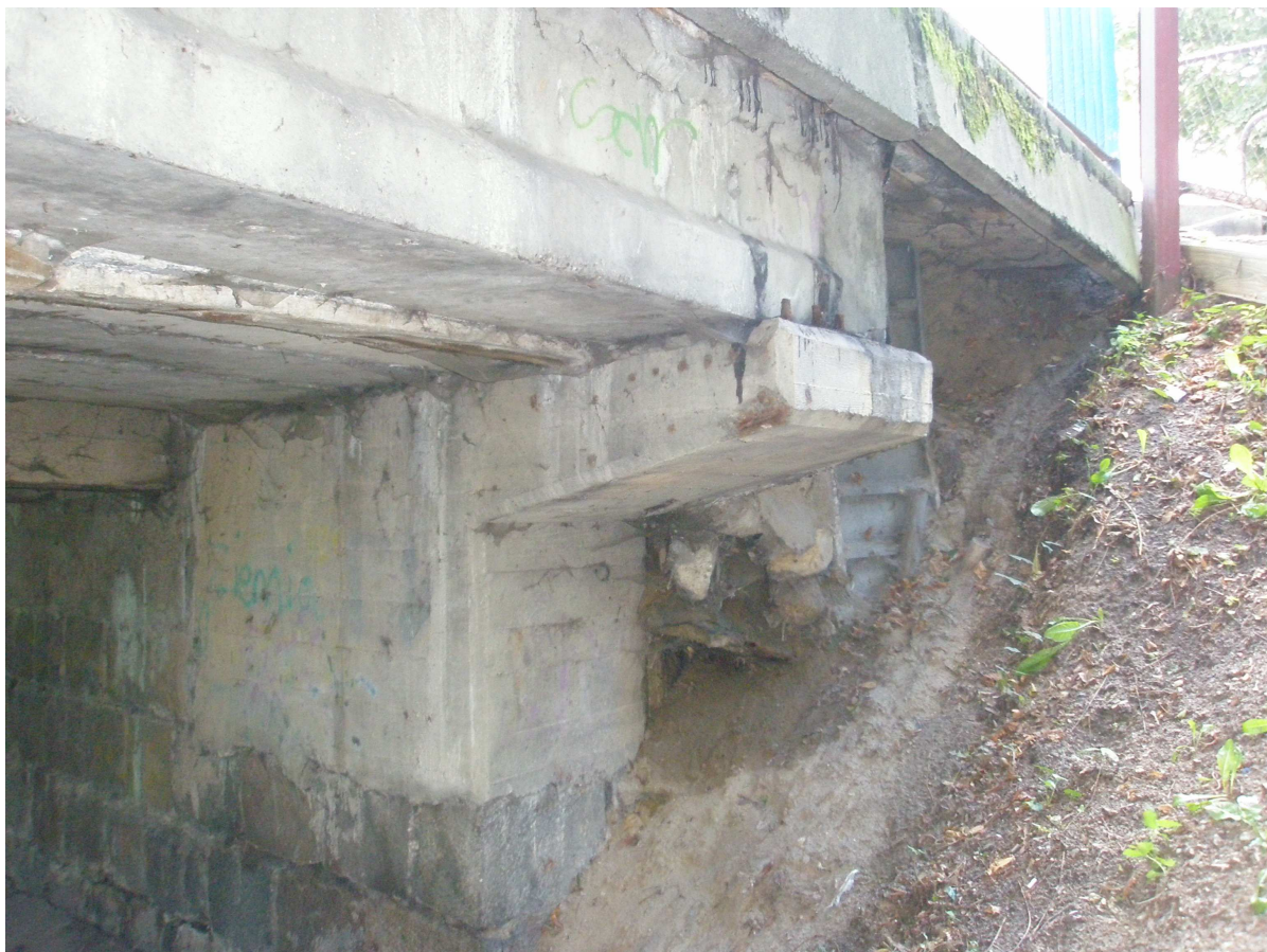
FOT. 3 – mchy powstałe na gzymsach, korozja betonu, wymywanie nasypu
