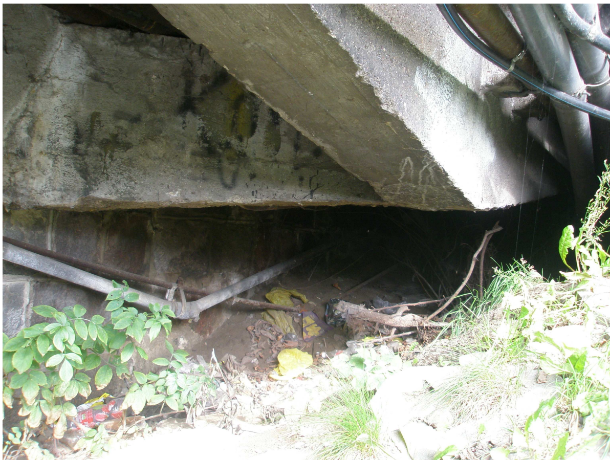
FOT. 4 – Ubytki gruntu w nasypie stożków
