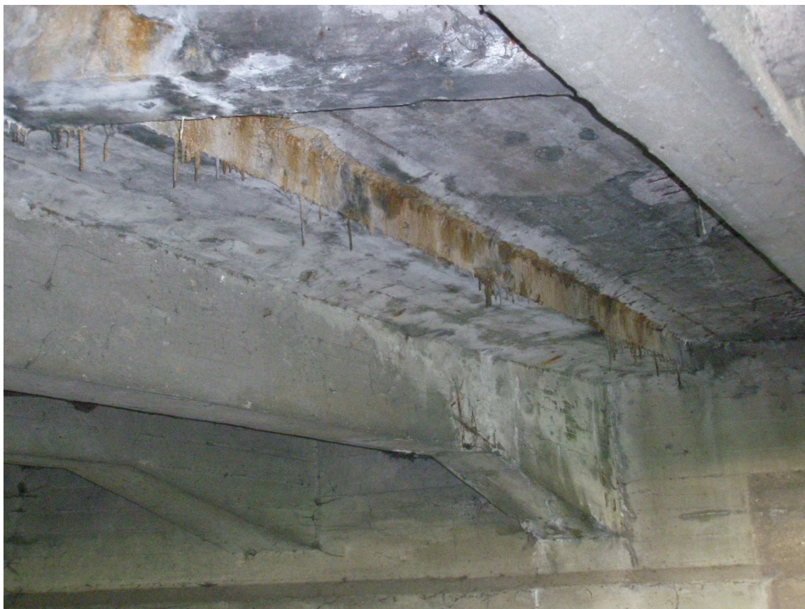
FOT. 1 – korozja betonu, przecieki przez płytę pomostu
