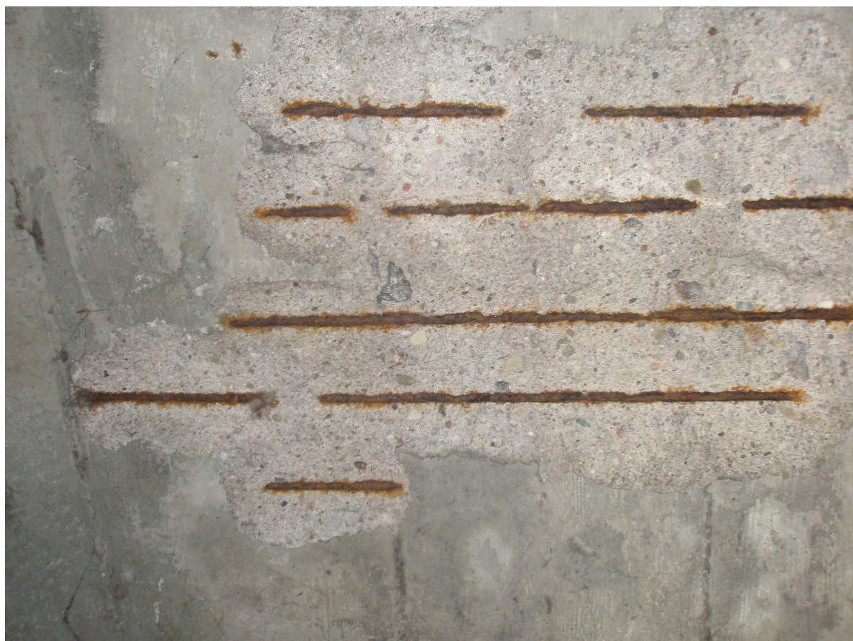
FOT. 2 – brak otuliny, skorodowane zbrojenie płyty
