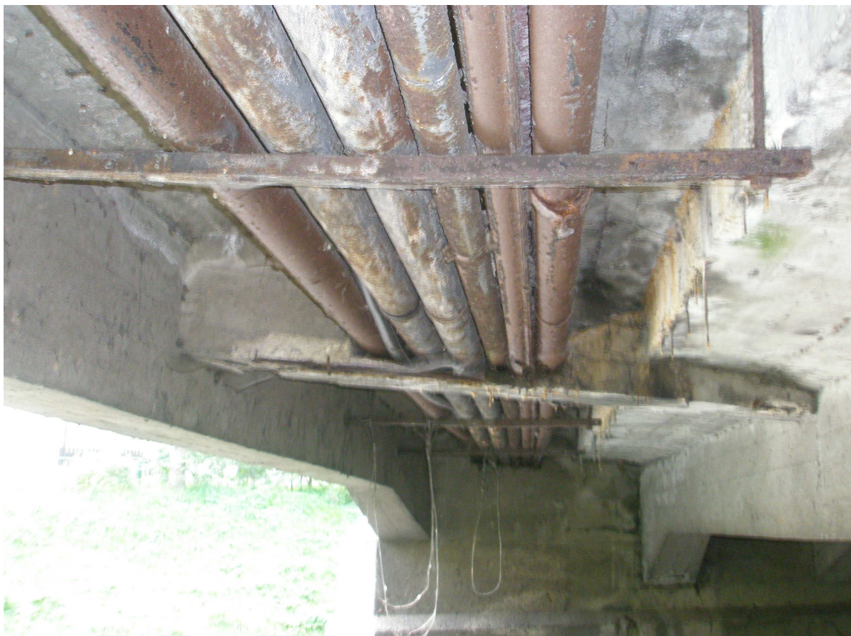
FOT. 5 – Korozja rur ochronnych urządzeń obcych, korozja betonu, przecieki przez płytę pomostu
