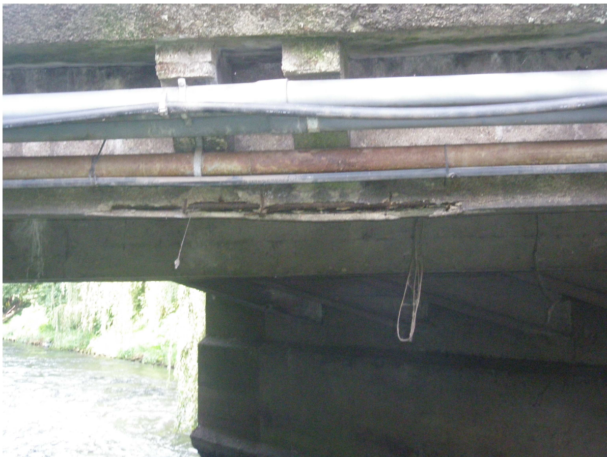
FOT. 3 – odspojenie otuliny i korozja zbrojenia głównego dźwigarów
