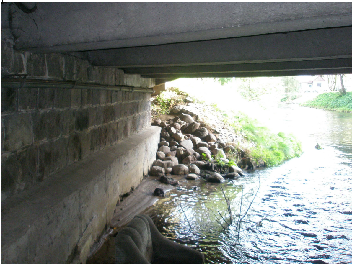
FOT. 6 – Zniszczone umocnienie stożków, brak zabezpieczenia przyczółka przed działaniem wody, zanieczyszczenie koryta rzeki
